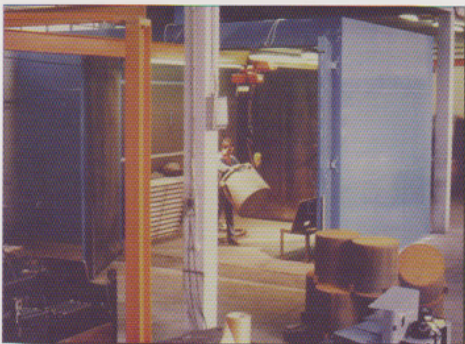
Hawker Siddeley Switchgear
